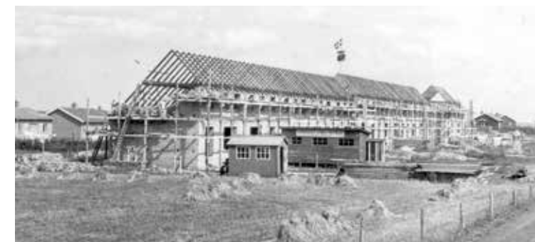
▲ Rejsegilde på rækkehuset "Næsset" på Islandsvej, som blev opført 1950-52 efter tegninger af Jens Jakobsen. Bemærk til højre de små finske træhuse, opført 1947-48, og til venstre privatboligerne langs Norgesvej, hvoraf de fleste blev opført sidst i 40'erne, og for mange af dem indgik elementer fra tyskerbarakker i byggematerialerne. Gunnar Hansen tegnede husene på Norgesvej og stod bi ved opførelsen af de finske træhuse. Kilde: Historisk Arkiv, VHM.
